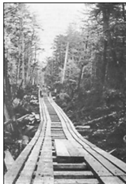
Figure 1-18 Le personnel d'une UCE construit une route de madriers menant à un site éloigné
