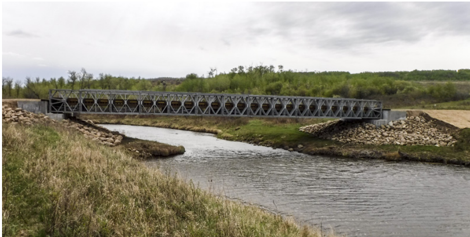
La construction du pont Purple, une structure modulaire en acier mesurant 40 m, s'est achevée à temps pour l'exercice MAPLE RESOLVE 2016.
