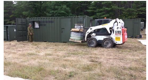
Des bobines de câbles électrique furent commandées pour faire les connections entre les modules CTD.
