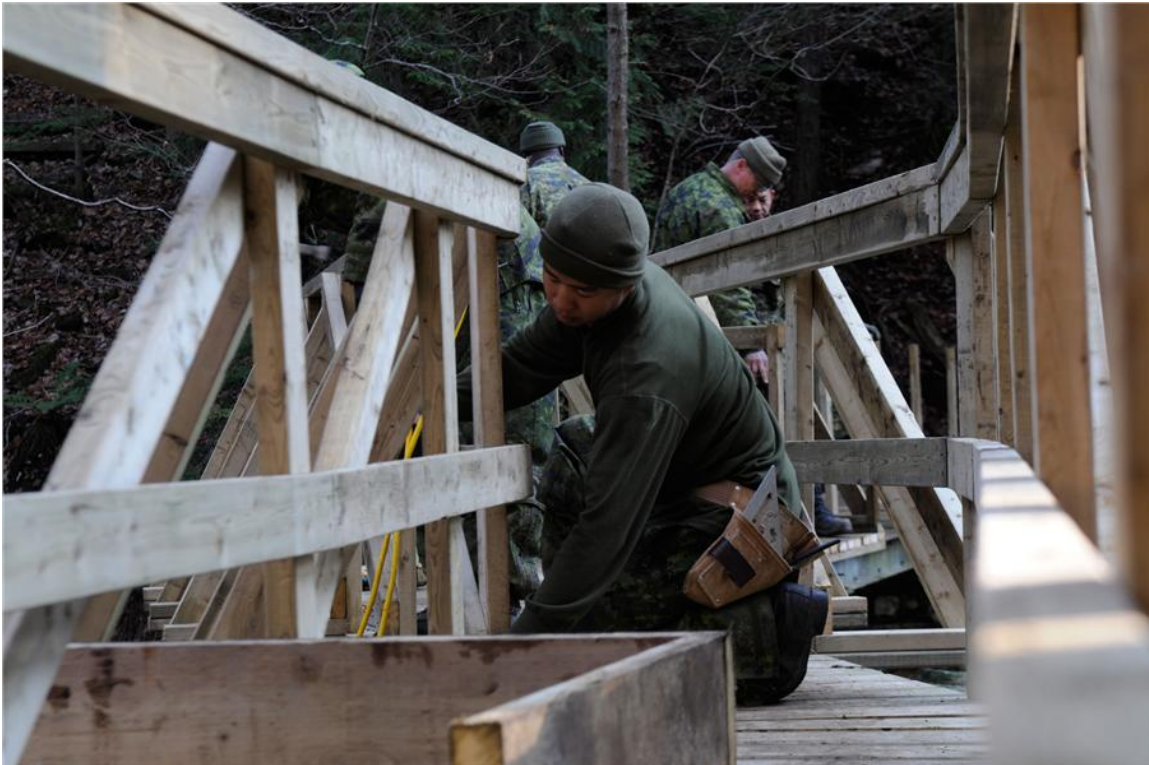
Le Sgt Andy Thomas apporte la touche finale à la rampe de la passerelle du ruisseau Mill
